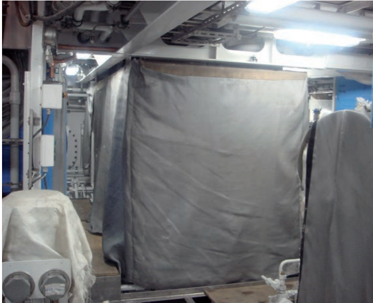
Enveloppes de moteurs Diesel dans des bateaux
