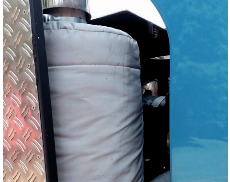
Isolierung eines Rußpartikelfilters
