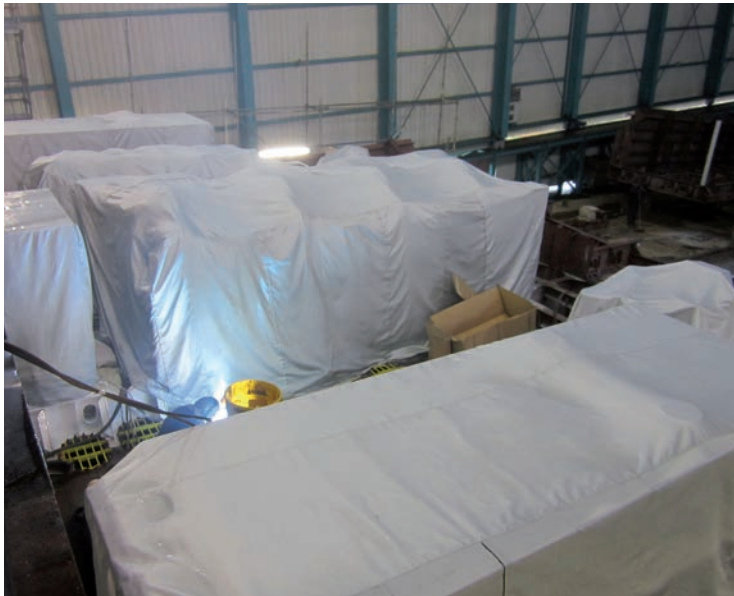
Aggregatverhüllungen in Werften bei Schweißarbeiten
